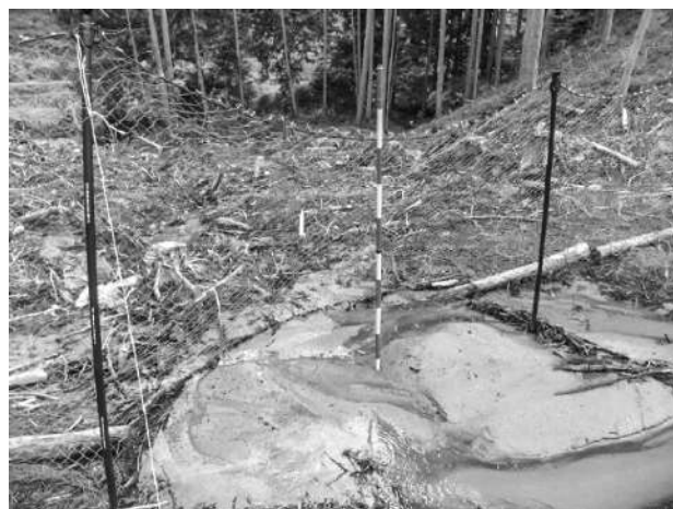
写真1 沢跨ぎ対策の欠如による損壊
