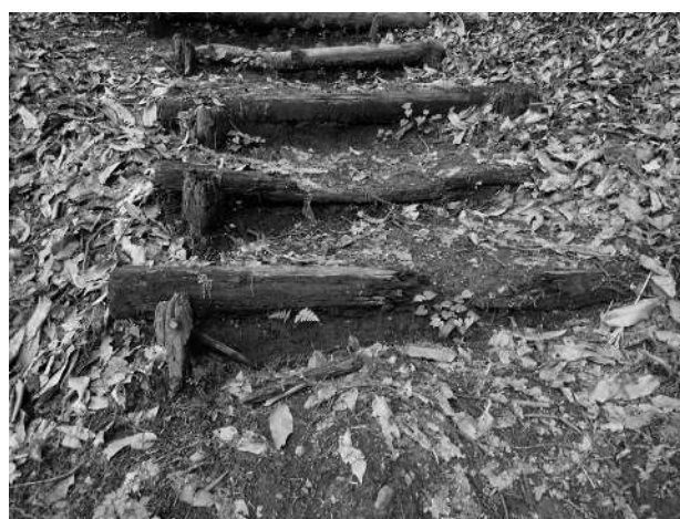
（写真4：腐朽が進行する丸太階段）
